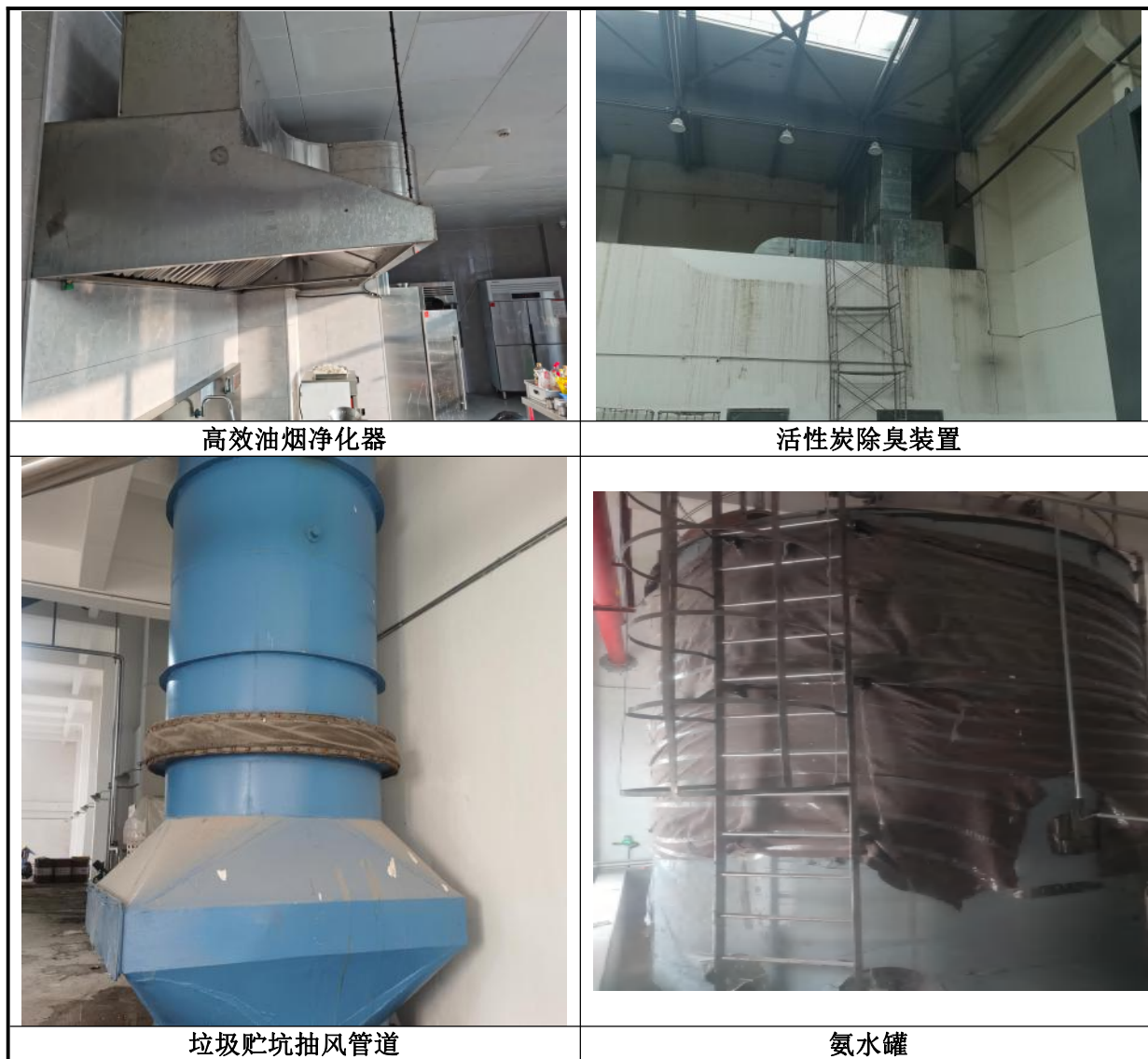
图 4-4 废气处理相关设施
