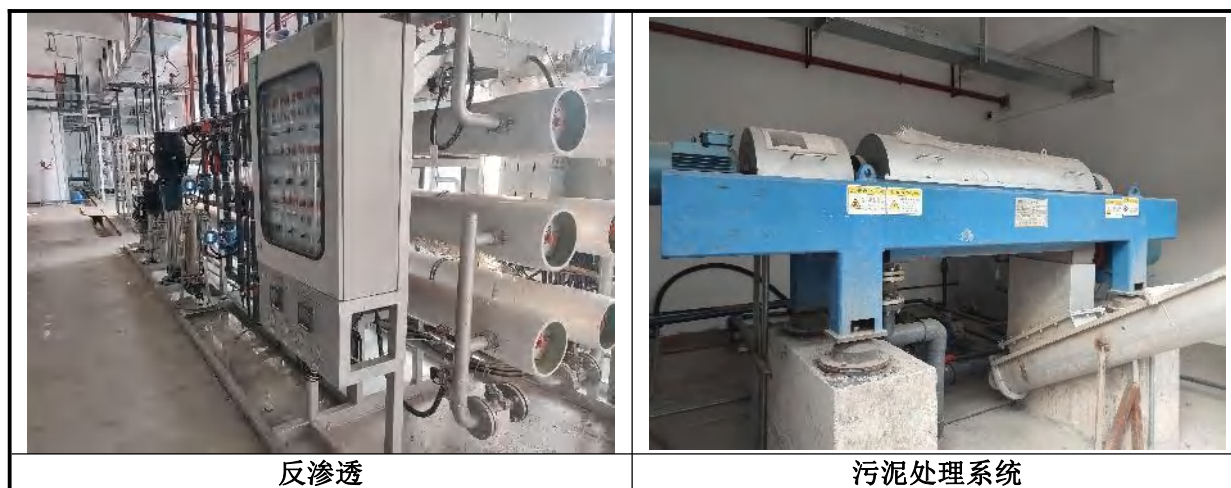
图 4-3 渗滤液处理站相关设施
