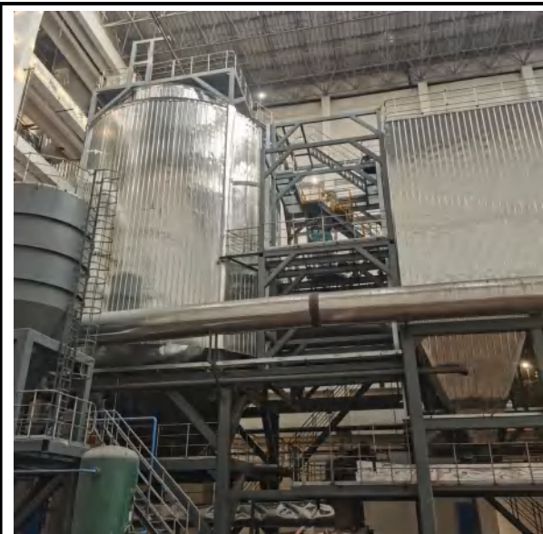
焚烧烟气处理设施
