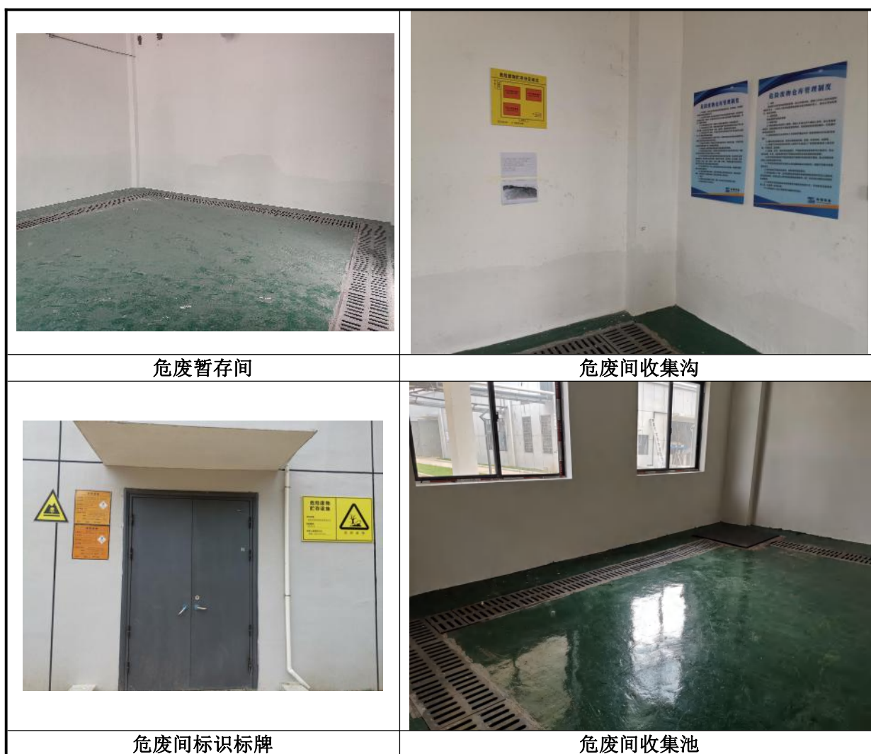
图 4-5 危废暂存间现场照片
