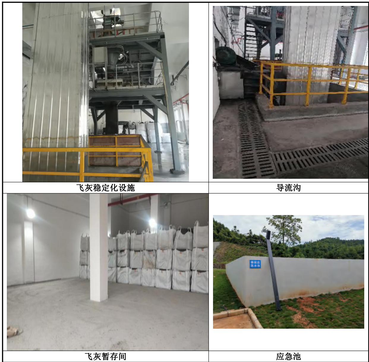
图 4-6 飞灰稳定化设施及暂存仓库现场照片
