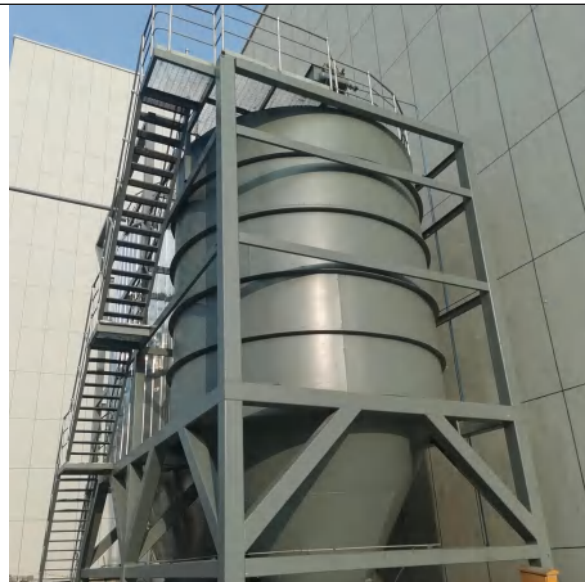
水泥仓除尘器
