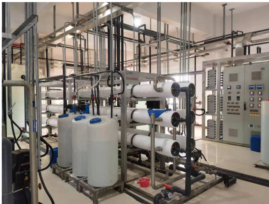
图 2.3-2 除盐水制备系统
