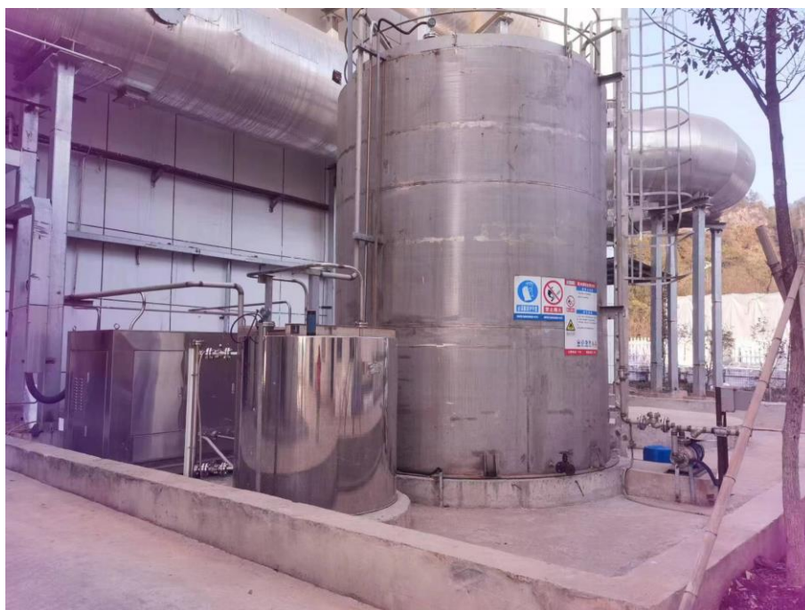
图 2.3-5 废气处理处理及氨水制备系统
