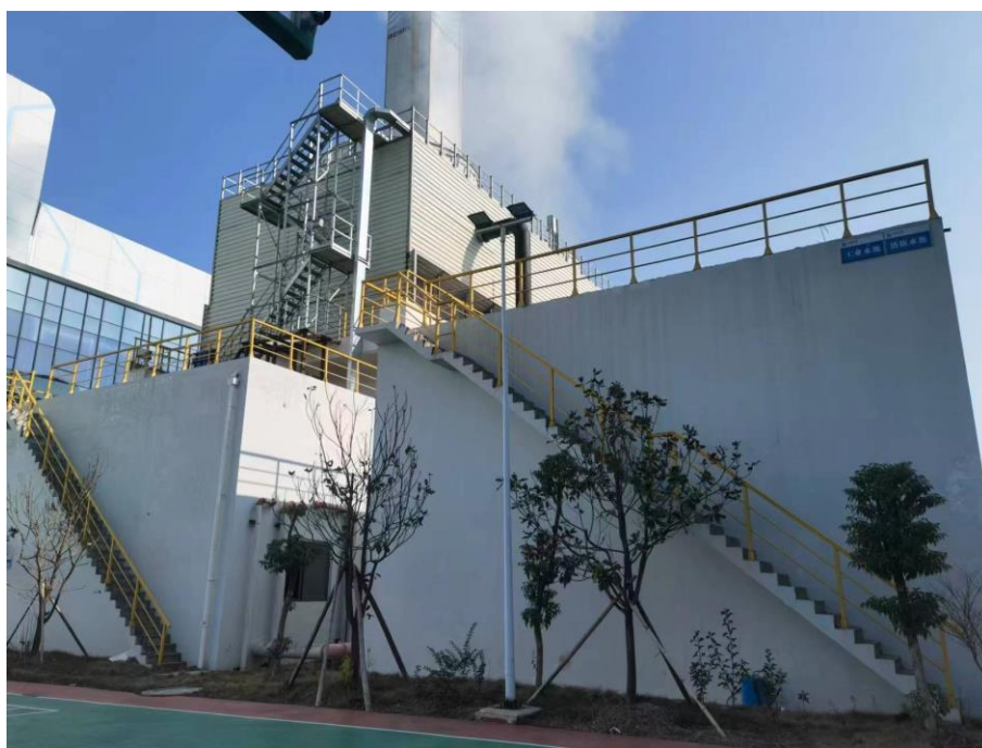
图 2.3-1 厂区循环水池及冷却塔
