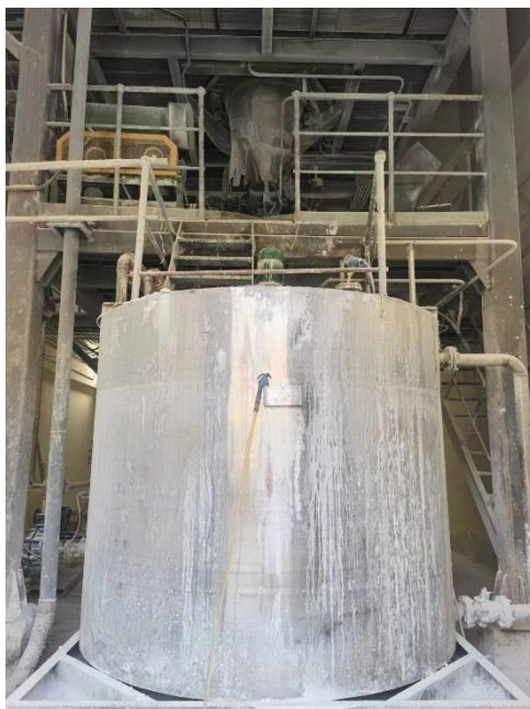
图 2.3-6 石灰制浆系统
